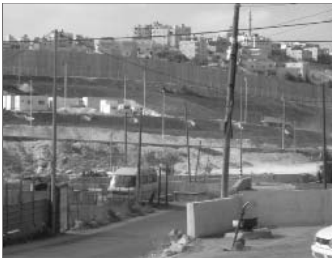
Costruzione del muro di sicurezza a protezione di nuove abitazioni ebraiche nei pressi di Gerusalemme.
